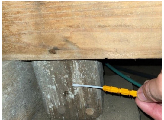
写真1 建造物の床下に生えたカビ
